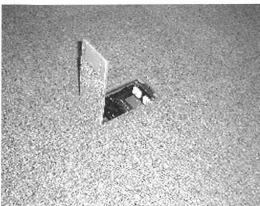
写真2 電源と情報コンセント
